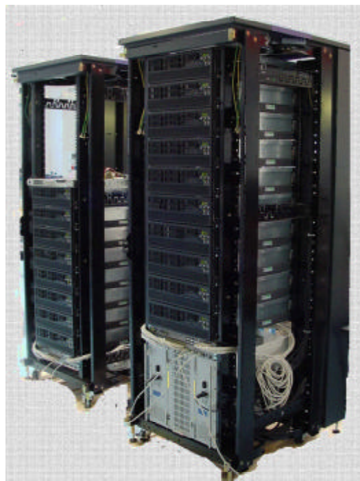
Fig. 2 - Una foto del cluster golgi.cilea.it durante l'installazione. Un armadio non è rappresentato.
